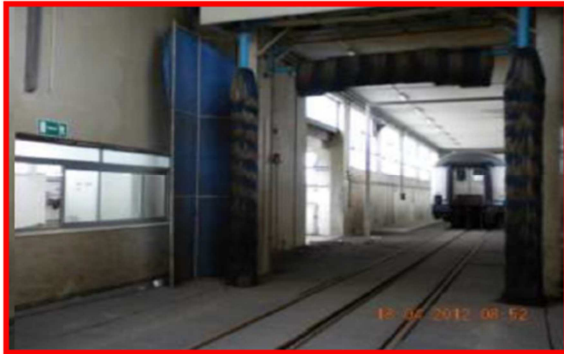
Figura 13 Impianto lavaggio carrozze
