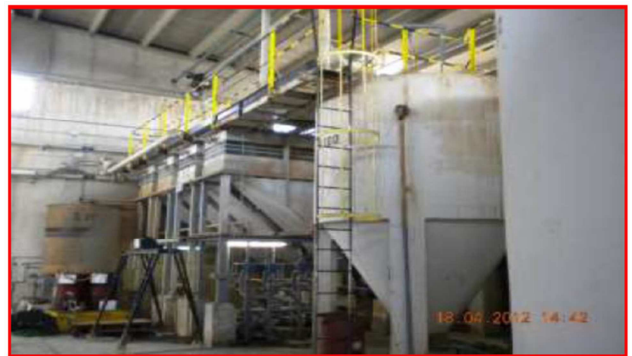
Figura 20 Impianto di depurazione
