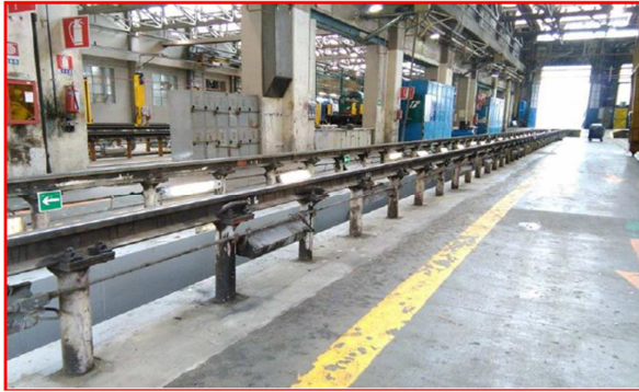
Figura 1 Binari sopraelevati su colonnine
