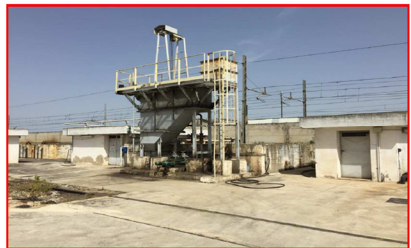
Figura 22 Impianto di depurazione
