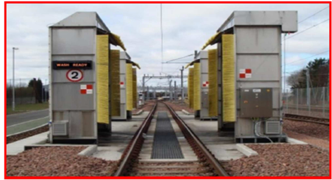
Figura 14 Impianto lavaggio carrozze
